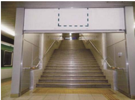
防火防煙シャッター
