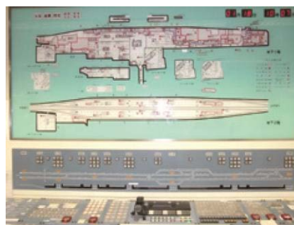
地下線防災監視盤
