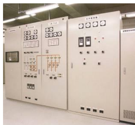
守口変電所内設備機器
