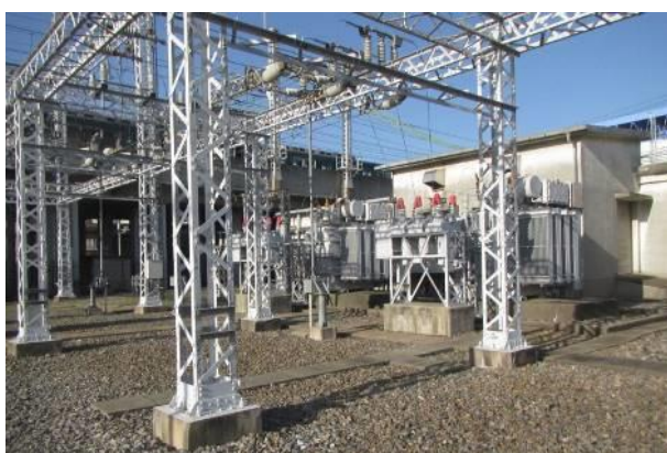
守口変電所の現況
